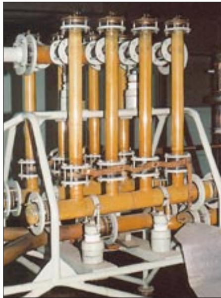
Diese Kunstantenne vermag mit 250 kW Wasser zu erwärmen.
