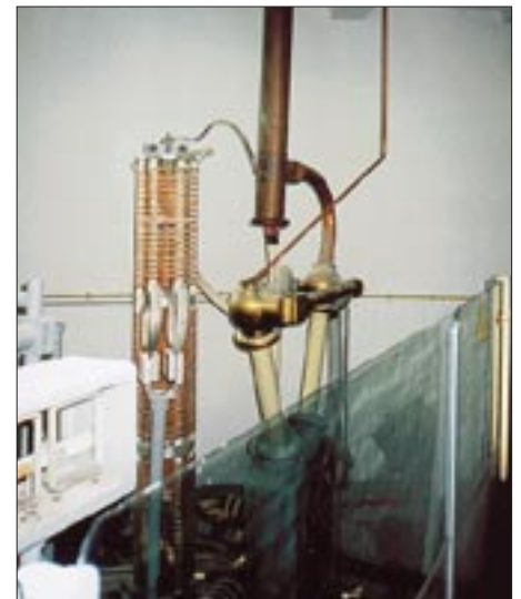
Erdschalter, Speiseleitung und Spannungsverdrosselung für die Flugsicherungsbeheizung am Fuß des Sendemastes
